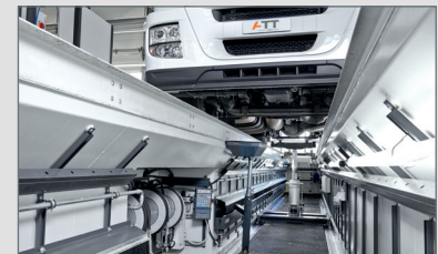
Fertigrube truckbay Ihre maßgeschneiderte Prüf- und Wartungsgrube für LKWs und Busse.
